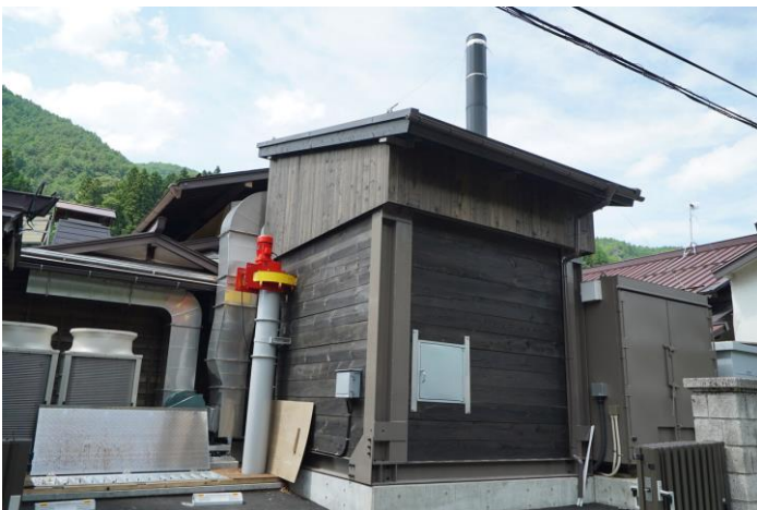
左からチップの垂直搬送機、木製チップサイロ、ボイラコンテナ。チップはダンプから直接投入できます。
