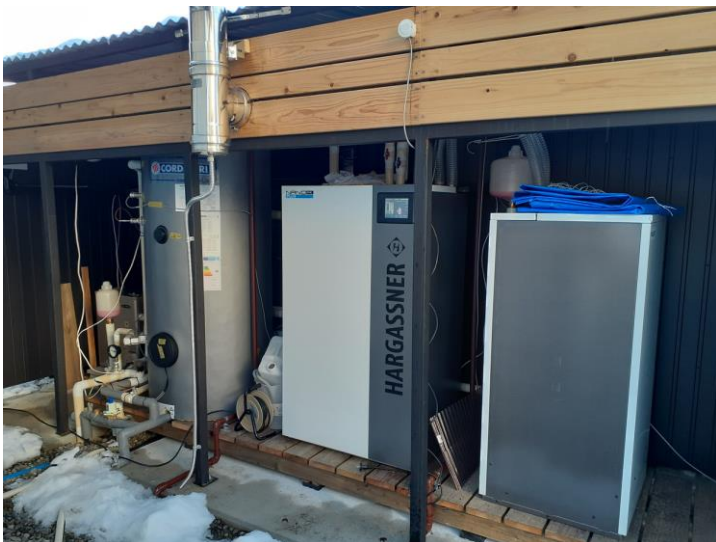
左から貯湯槽、ペレットボイラ、ペレットサイロ
