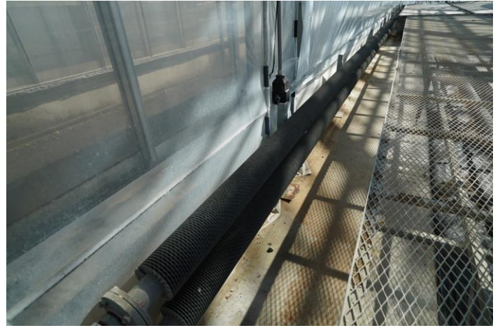
ボイラで作った温水はハウス内のエロフィン・チューブを介して自然対流で放熱されます。
