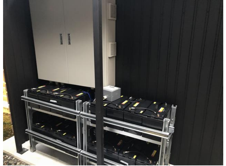
オフグリッド用に19.2kW e の蓄電池。導入コストを低減するために鉛電池を使っています。
